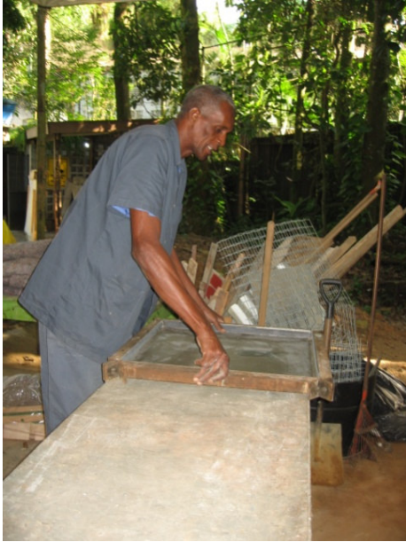
Figura 31. Preparo de forma metálica para receber compósito de fibroso e ser posicionada em mesa vibratória.
